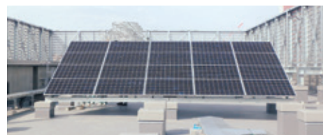
太陽光発電設備
