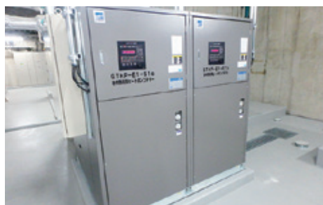
地中熱ヒートポンプ設備
