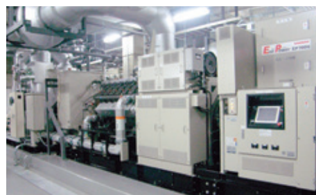
ガスコージェネレーション
