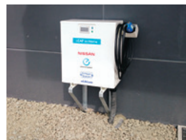
電気自動車充放電設備
