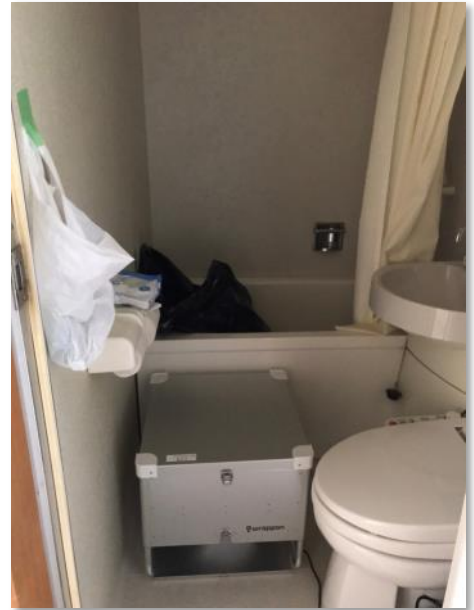
ユニットバス内にラップポン（簡易トイレ）を設置
