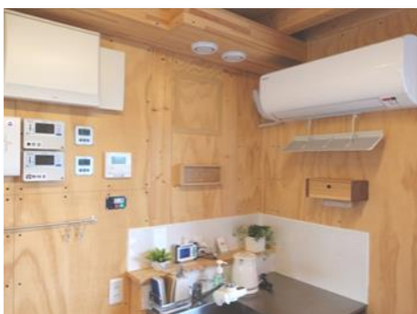
コンテナ内の電源は、ソーラー及びプロパンガス発電で供給される
